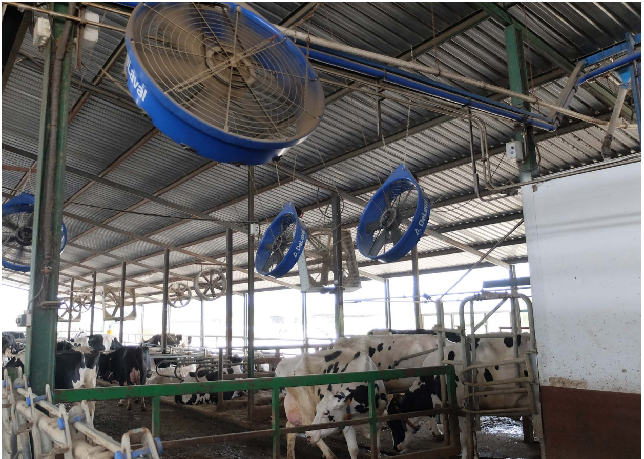
Ventilatoren müssen am Bedarf ausgerichtet werden.
