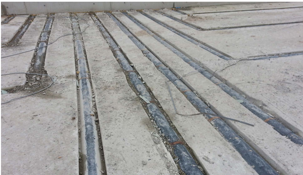
Die Belüftungsrohre befinden sich unter der Kompostmatte.
