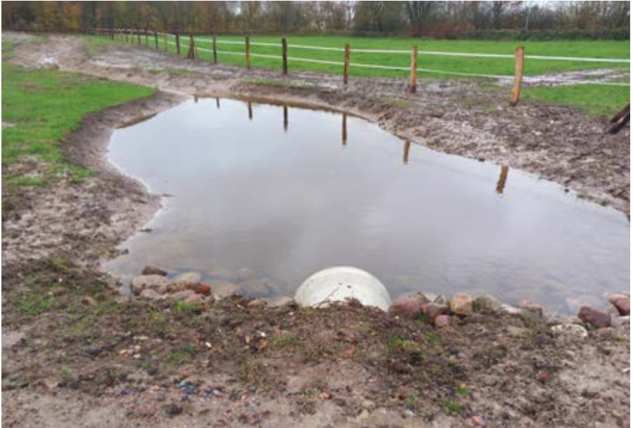
Abbildung 23: Die Abflussmulde nimmt das Oberflächenwasser der umgebenden Fläche auf, verhindert den unkontrollierten Abfluss und schützt vor Überschwemmungen auf der Fläche. Durch einen geregelten Ablauf kann das Wasser gezielt und kontrolliert abgeleitet werden.
