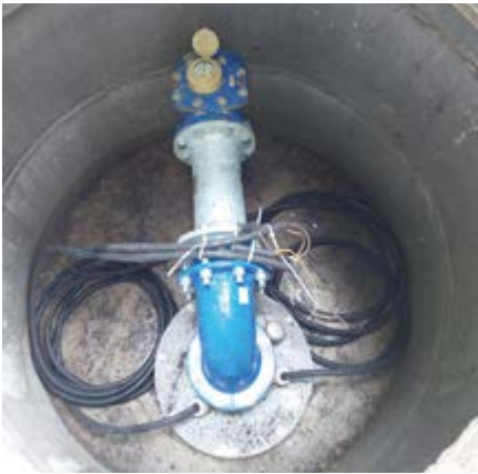
Abbildung 5: Über Wasseruhren (oben im Bild) kann die Entnahmemenge kontrolliert werden.
